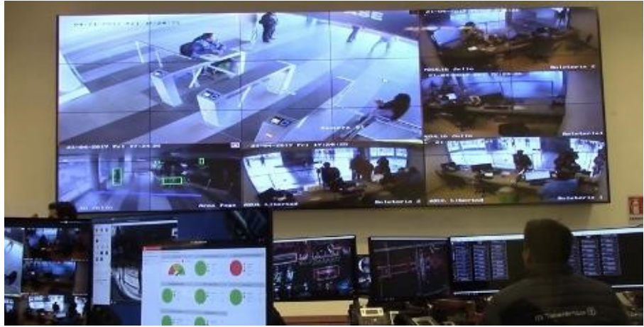
CCM – Centro del Control y Monitoreo
